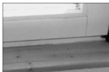
Note 2: Beginnende Abnutzungserscheinungen an den Fenstern
