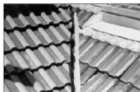
Note 3: Nicht fluchtende Kehlenschnitte sowie teils lose Dachsteine im Kehlenbereich
