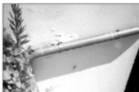
Note 4: Rissbildung und Putzabplatzungen
