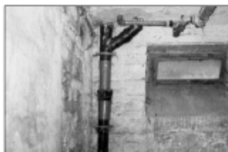
Note 4: Zusammengestückeltes, altes Abwasserrohr
