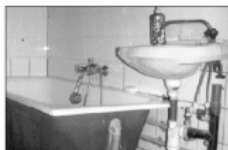
Note 5: Bad mit ausgebeSSERTen Fliesen, veraltete Sanitärkeramik
