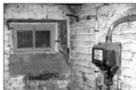
Note 5: Feuchtes Mauerwerk in schlechtem Zustand
