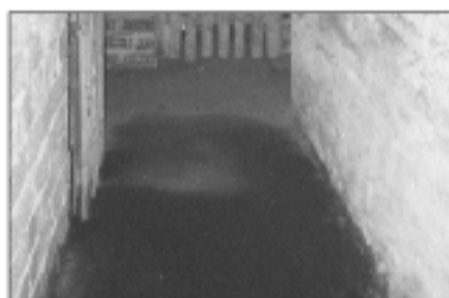
Note 5: Durchfeuchtung des Kellers
