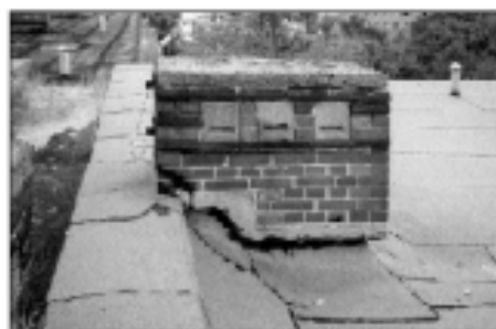
Note 4: Größere Nachbesserungen in Teilbereichen
