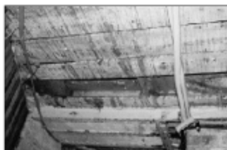
Note 5: Marode Holzdecke im Kellergerüst
