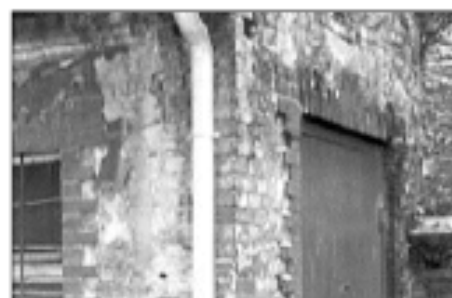
Note 5: Mangelhafter Gesamtzustand
