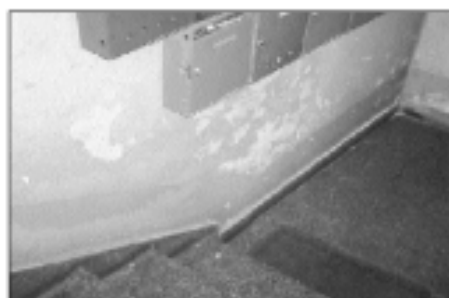
Note 5: Verfallene Briefkastenanlage
